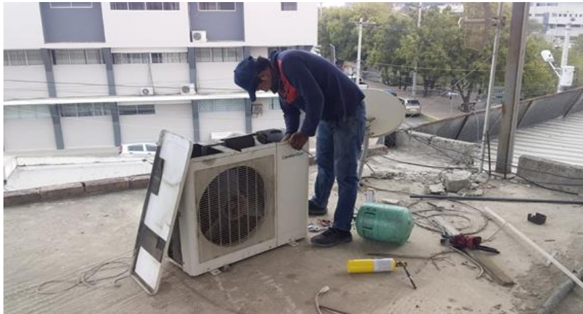
Gráfico 33: Mantenimiento aires acondicionados Fuente: Dirección de Infraestructura, Obras y Patrimonio
