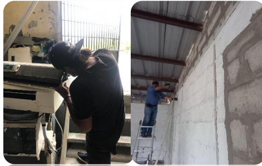
Gráfico 43: Mantenimiento correctivo en oficinas
